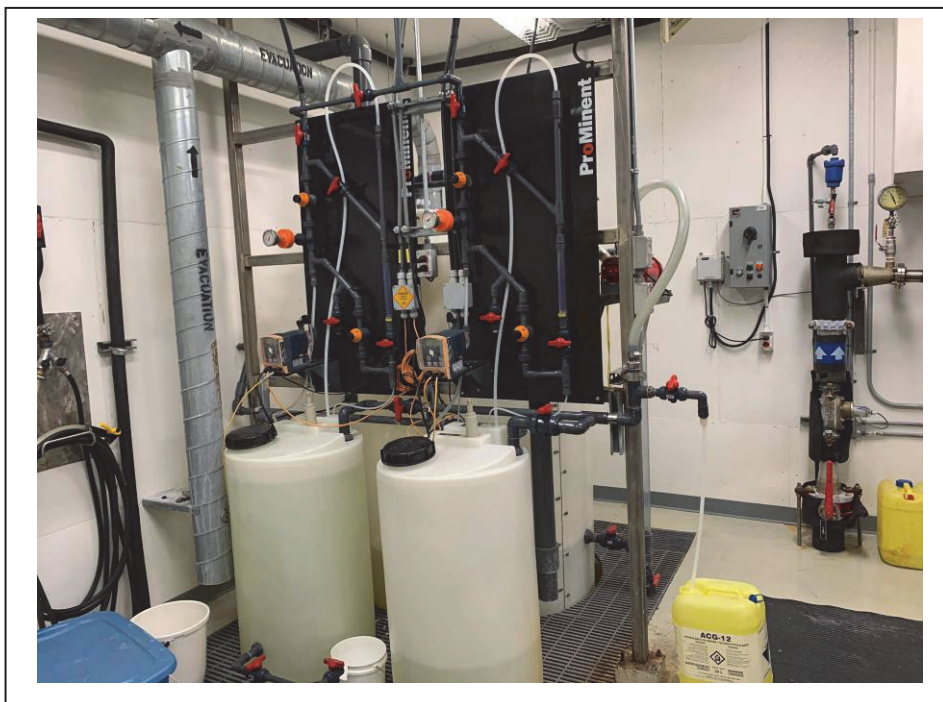
Photo 10 : Système de chloration – 2020-11-03
