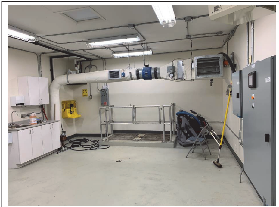
Photo 14 : Vue générale du poste de distribution – 2020-11-03
